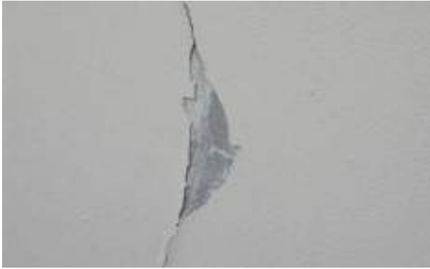
1 | Beschadiging van een alkydverf die op een niet-gecarbonateerde betonnen ondergrond en bij aanwezigheid van vocht toegepast werd.
